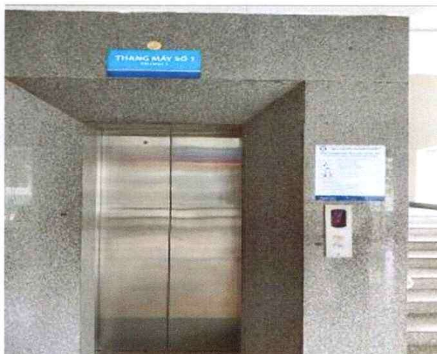
Thang máy khu 6 tầng
