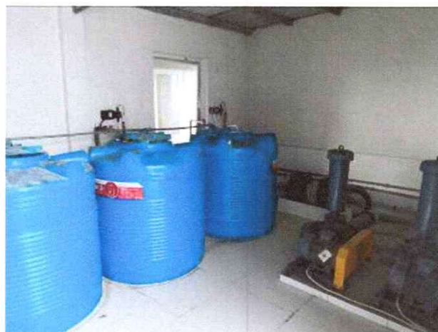
Bể chứa nước và bể xử lý nước thải
