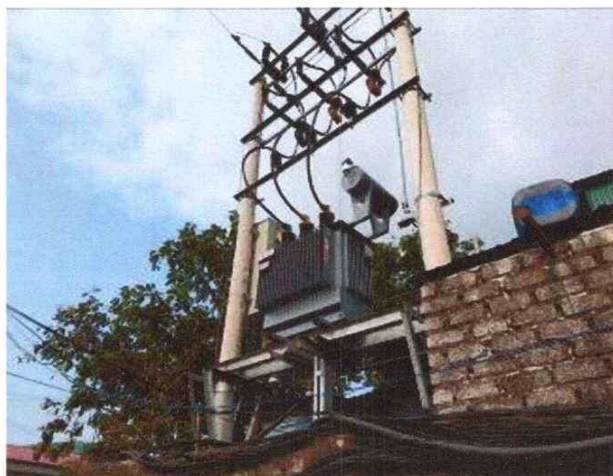
Trạm biến áp 250KVA
