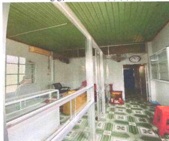
Tường gạch mái tôn (7)
