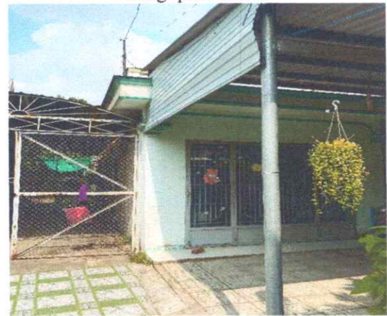
Tường gạch mái tôn (4) (5) (6)
