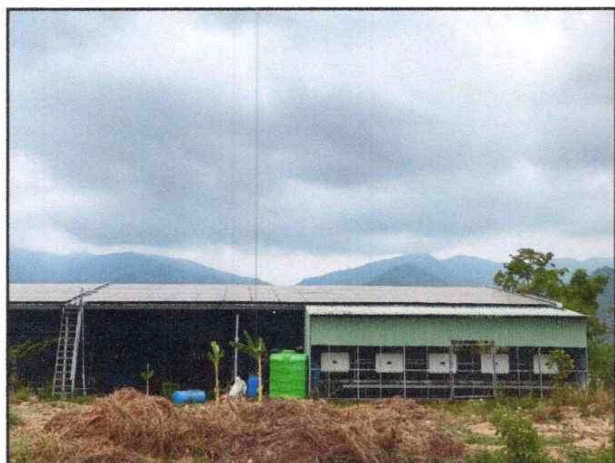
Hiện trạng hệ thống điện năng lượng mặt trời và Tủ điện Inverter
