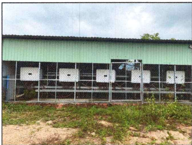
Hiện trạng tủ điện inverter
