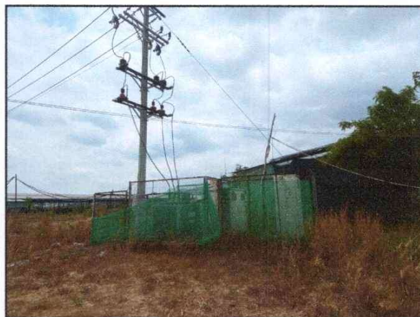
Hiện trạng hệ thống trạm biến áp
