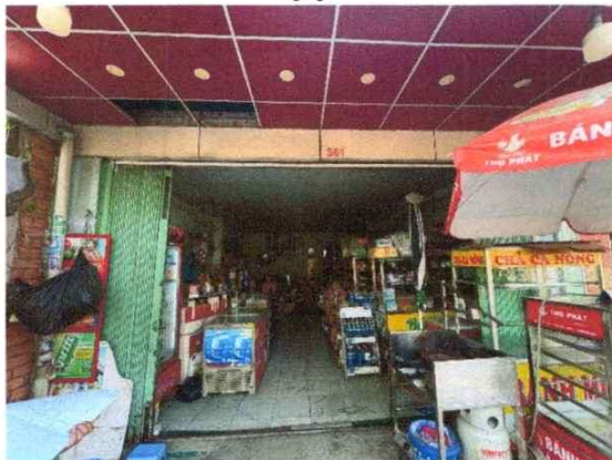
HIỆN TRẠNG TÀI SẢN - TƯỜNG GẠCH MÁI TÔN (11)
