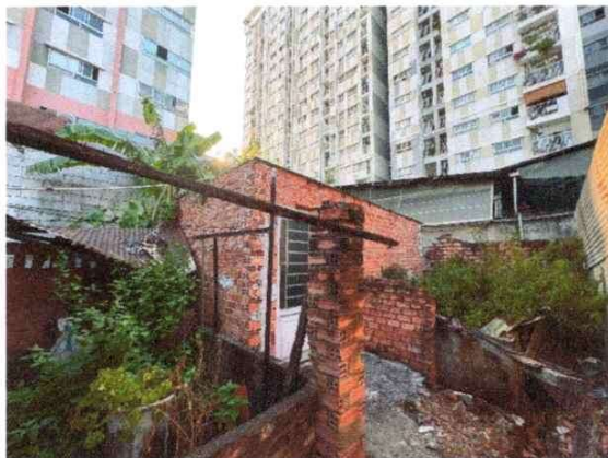
HIỆN TRẠNG TÀI SẢN – TƯỜNG GẠCH MÁI TÔN (20)
