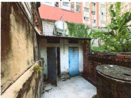
HIỆN TRẠNG TÀI SẢN - TƯỜNG GẠCH MÁI TÔN (12)
