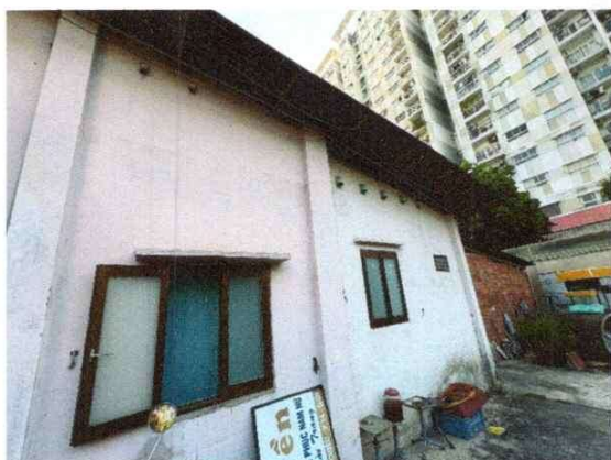
HIỆN TRẠNG TÀI SẢN – TƯỜNG GẠCH MÁI TÔN (18) + (19)
