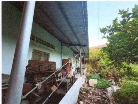
HIỆN TRẠNG TÀI SẢN - MÁI TÔN (13)
