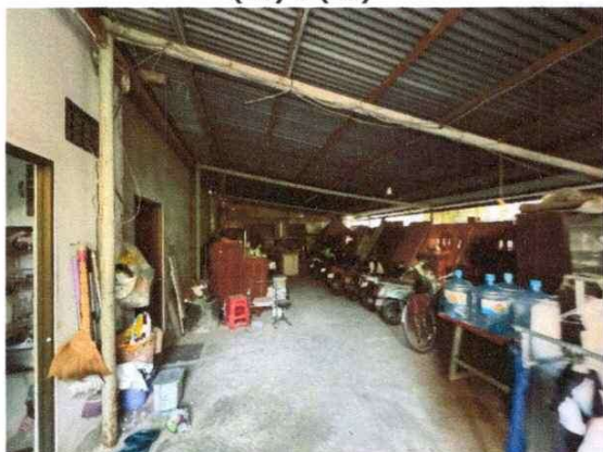
HIỆN TRẠNG TÀI SẢN – TƯỜNG GẠCH MÁI TÔN (21) + (22)
