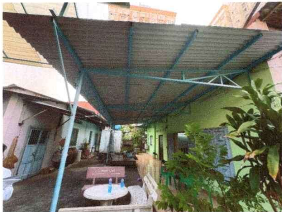
HIỆN TRẠNG TÀI SẢN – MÁI TÔN (16) + (17)
