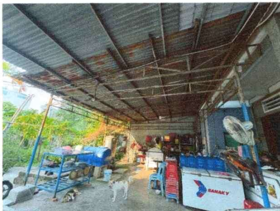
HIỆN TRẠNG TÀI SẢN - MÁI TÔN (5)
