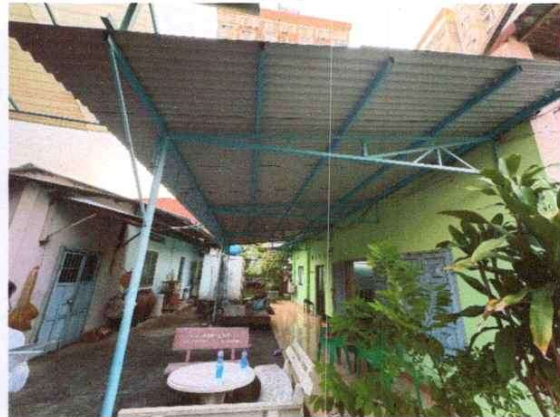
HIỆN TRẠNG TÀI SẢN – MÁI TÔN (16)
