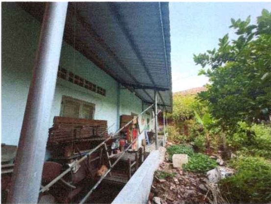
HIỆN TRẠNG TÀI SẢN - MÁI TÔN (13)
