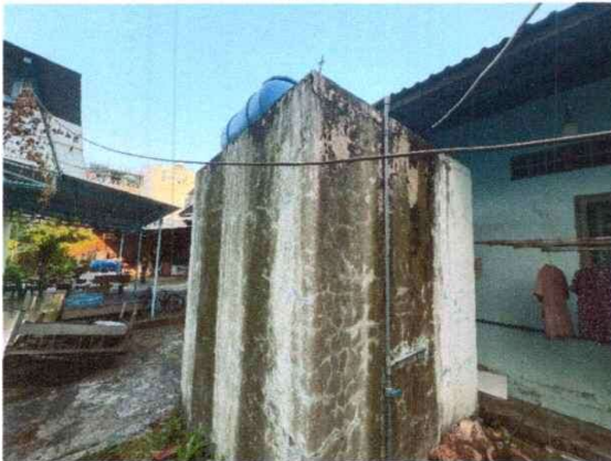
HIỆN TRẠNG TÀI SẢN – TƯỜNG GẠCH MÁI ÔN (15)
