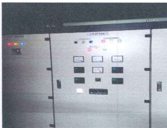
Hệ thống tủ điện
