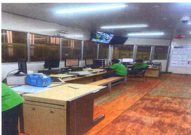
Hệ thống lập trình PLC
