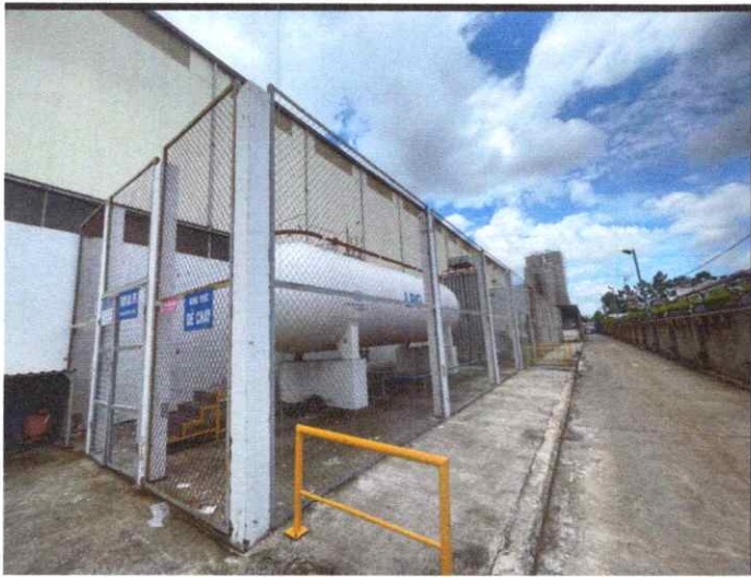
Trạm gas ngầm
