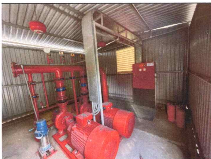
Hệ thống PCCC và nước sinh hoạt
