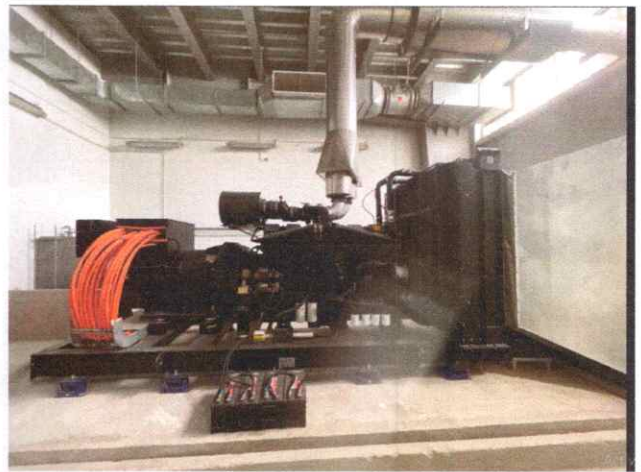
Máy phát điện
