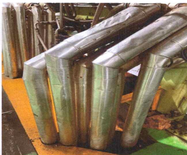
Đường ống dẫn dầu tải nhiệt
