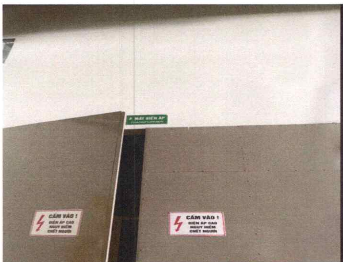
Trạm biến áp và đường dây trung thế
