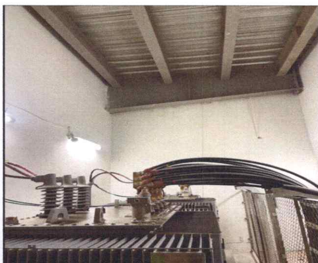
Trạm biến áp và đường dây trung thế
