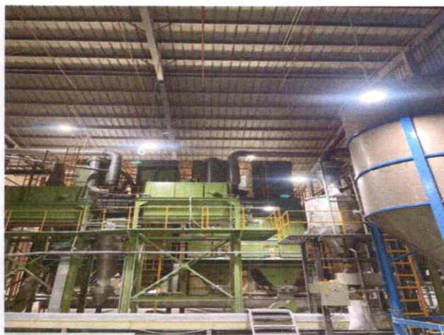
Hệ thống hút bụi
