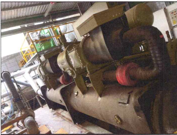
Hệ thống làm lạnh nước
