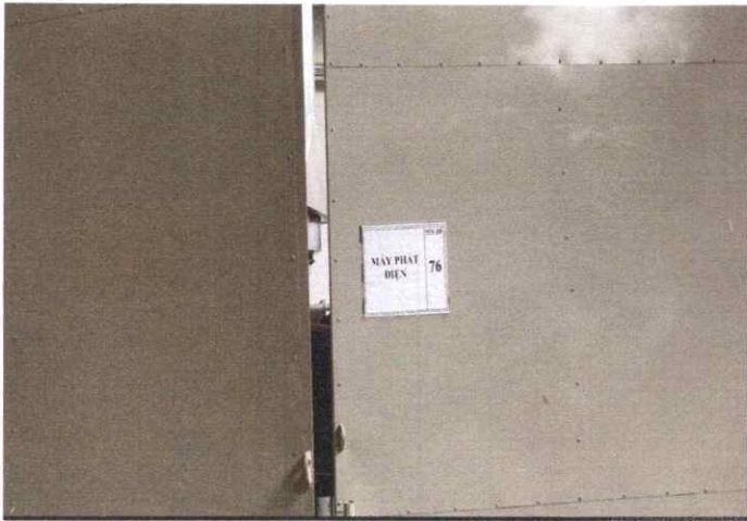
Máy phát điện
