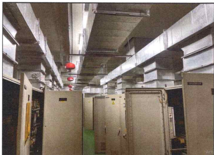
Hệ thống cơ điện
