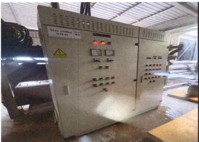
Tủ điện và vật tư lắp đặt khác
