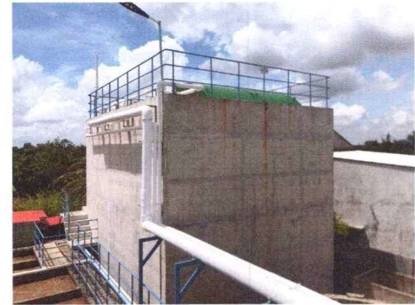
Bể kị khí UASB
