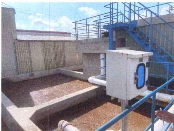
Hệ thống xử lý nước thải nhà máy Mỹ An công suất từ 500M3/ngày đêm lên 950M3/ngày đêm
