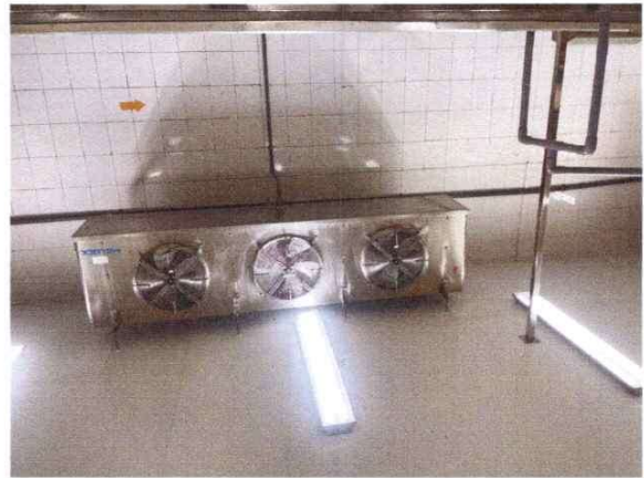
Bộ điều hòa 15hp
