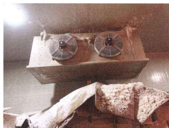
Dàn lạnh (kho3), cụm máy nén Bitzer 30HP, tháp giải nhiệt và bơm nước
