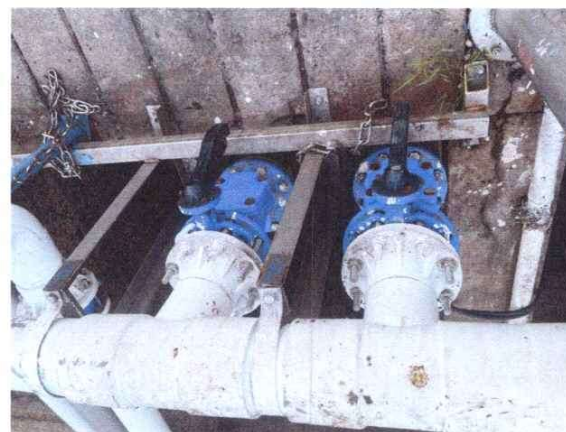
Hệ thống xử lý nước thải nhà máy Mỹ An công suất từ 500M3/ngày đêm lên 950M3/ngày đêm
