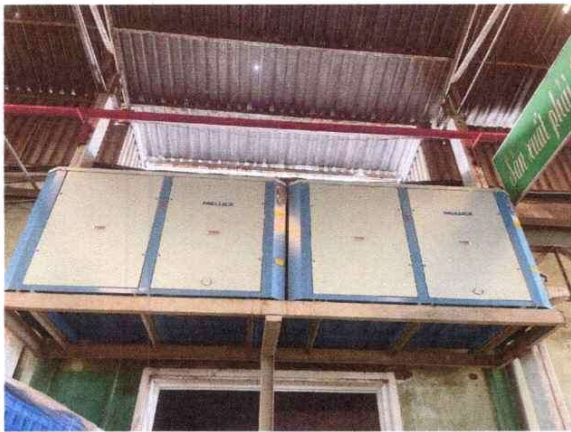
Bộ điều hòa 15hp
