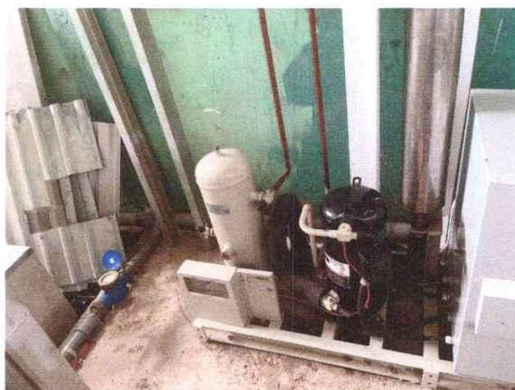
Hệ thống lạnh cho Phòng cân đa dầu và Hệ thống điều hòa nhiệt độ Phòng đóng gói và Cửa bản lề Tò vò, Joint ốp
