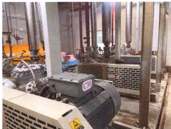
Hệ thống hầm đông gió (2 hầm đông)
