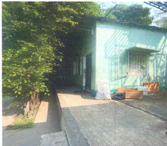
Hiện trạng nhà nghỉ
