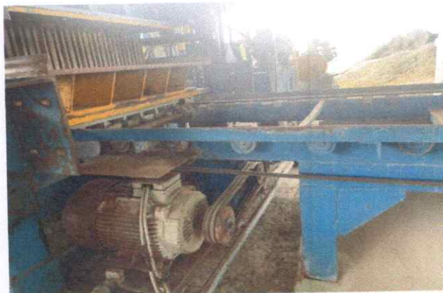
Hiện trạng máy cấp khay
