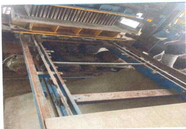
Hiện trạng máy cấp khay
