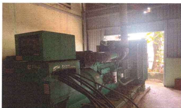
Máy phát điện 500KVA
