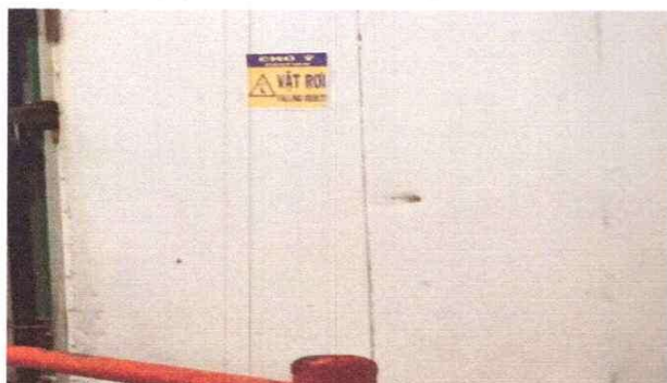
Hệ thống vỏ kho lạnh 800 tấn
